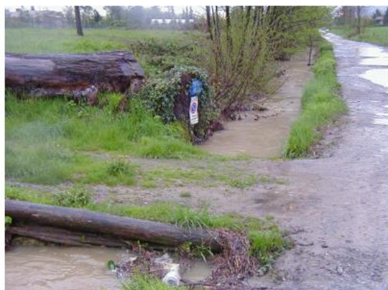
Fotografia 32 - Esempio di insufficienza idraulica di un manufatto di attraversamento del torrente Riolo (evento del 19.04.04).
