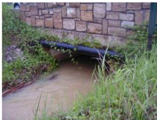
Fotografia 40 -Manufatto di attraversamento del Canale 2 in corrispondenza di via Villino (evento del 19.04.04).
