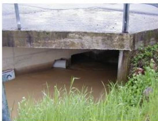
Fotografia 42 – Manufatto di attraversamento di via Pascolo dei Tedeschi nel tratto terminale del Canale 2 (evento del 19.04.04).
