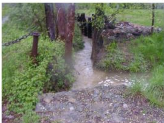
Fotografia 45 - Manufatto di attraversamento di via Pascolo dei Tedeschi nel tratto terminale del Canale 3 immediatamente a monte dell'immissione nel Canale 1 (evento del 19.04.04).
