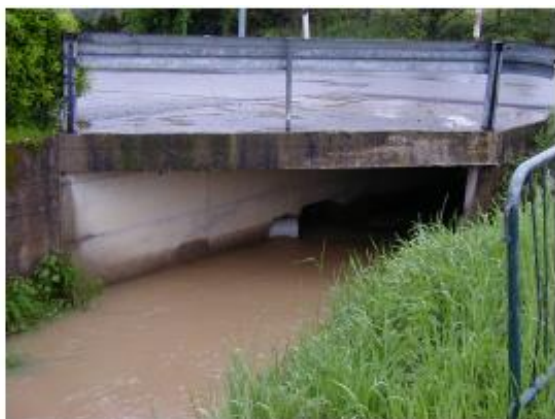
Fotografia 43 - Manufatto di attraversamento di via Pascolo dei Tedeschi nel tratto terminale del Canale 2 (evento del 19.04.04).
