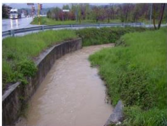
Fotografia 38 -Tratto del Canale 1 immediatamente a monte dell'imbocco del manufatto di attraversamento della S.P. n. 153 (evento del 19.04.04).
