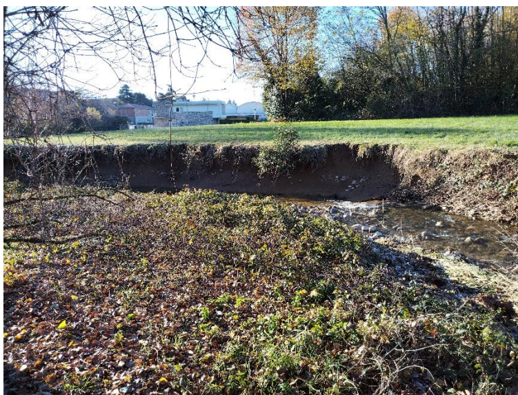
FIGURA 5 – EROSIONI SPONDALI LUNGO IL TORRENTE QUISA
