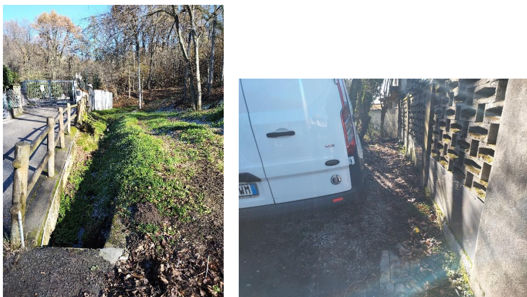
FIGURA 4 - PUNTO DI CRITICITÀ NELLE VICINANZE DELLA MADONNA DELLA CASTAGNA (A SINISTRA: INTERSEZIONE DEL CORSO D'ACQUA CON LA STRADA E TOMBOTTO INADEGUATO, A DESTRA: MISURE DI AUTOPROTEZIONE ARTIGIANALI ADOTTATE NELLA PROPRIETÀ ADIACENTE)
